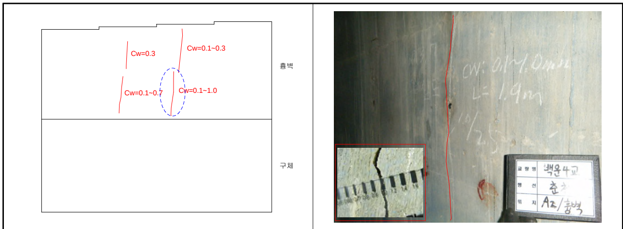
【그림 7.19】 백운4교(춘천) A2/흉벽 균열(0.3mm이상) 현황
